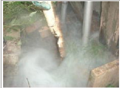
しまった！漏れている！
